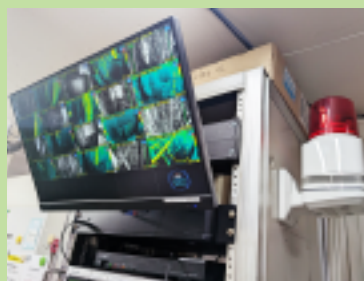
分電盤室に新設された警報付き監視カメラ
